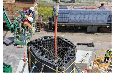
그림 19. 카이로스 파워는 3D 프린팅된 고분자 복합재( 검은 색 구조물 )를 사용하여 핵분열 원자로의 생물학적 차폐막용 기둥을 신속하고 정확하게 현장 타설 방식으로 제작했다. 출처 | Kairos Power
